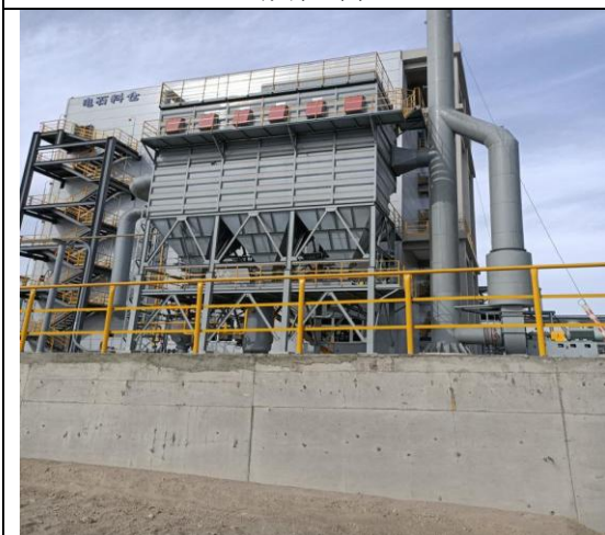
电石破碎除尘器 1
