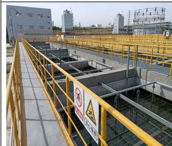
生化处理装置
