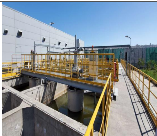
综合污水处理站
