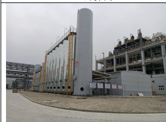
变压吸附装置
