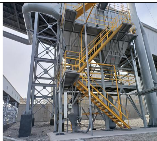
电石破碎除尘器 2
